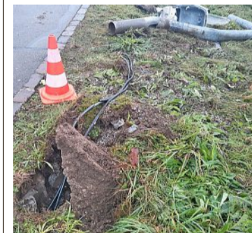
Von der Strassenlampe blieben nur zerbeulte Blech- und Kabelreste übrig. Foto: Christian Wüthrich
